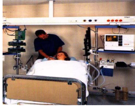
Gambar L5B Peralatan di ruang rawat pasien ICU menggunakan bedhead
